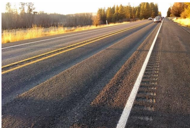
Рисунок 5.10 – Колея в результате сильного деформирования нижних слоев асфальтированной дороги
